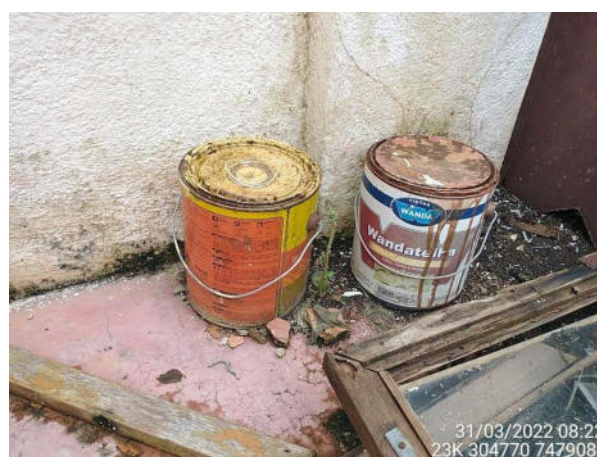
Foto 8 – Foram identificadas diversas latas de tinta espalhadas no interior da casa 32.
