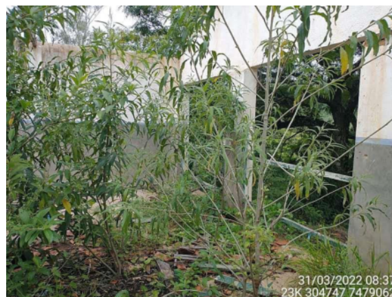
Foto 10 – Forte presença de vegetação no interior da estrutura, principalmente no banheiro.
