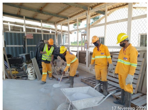
Foto 6 - Limpeza e organização na baía de materiais da usina de concreto. Data: (17/02/2022)
